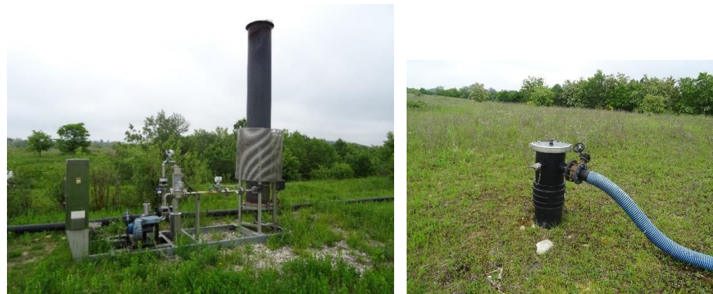
Torchère et puits de biogaz
